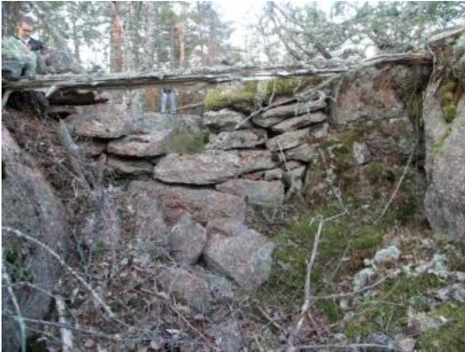
Kylmämuuratun huoneen takaseinä on keskeltä osin romahtanut. Kuva kohti SE. Kuva Tarja Knuutinen.
