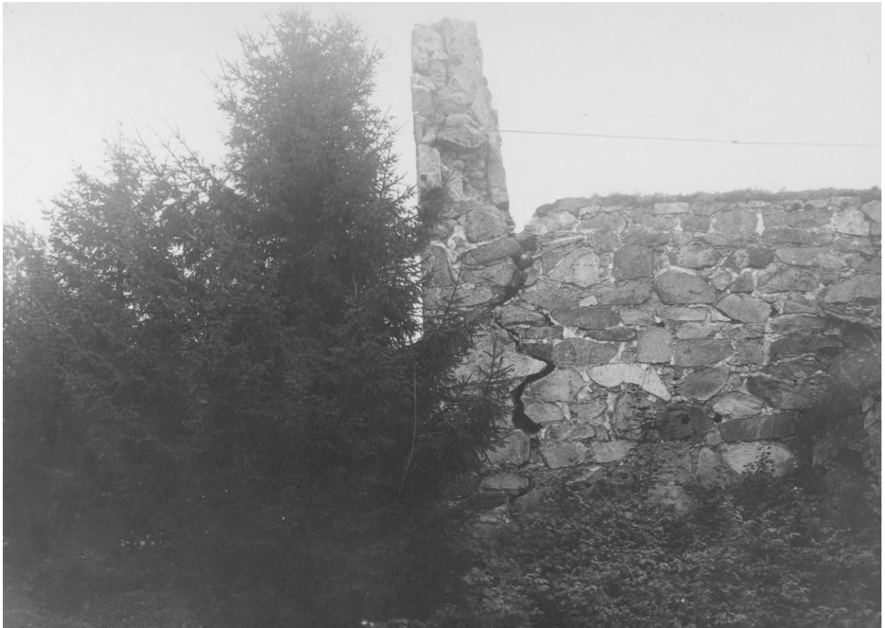
Kuva. Itäpääty oli irronnut sivuseinistä. Seinien väliin oli syntynyt repeämä. Sen korjaus sai odottaa vielä 20 vuotta. Museovirasto, Historian kuva-arkisto neg. 20087.
