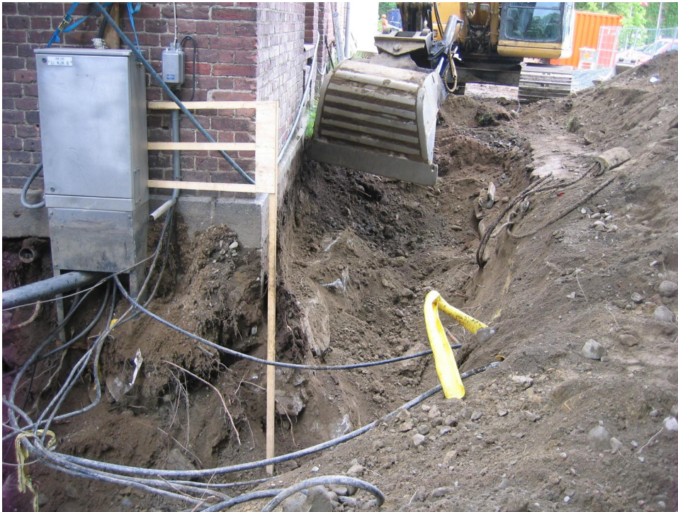
Kuva 1. Kaivannon K1e alkupään kaapelisuma.
