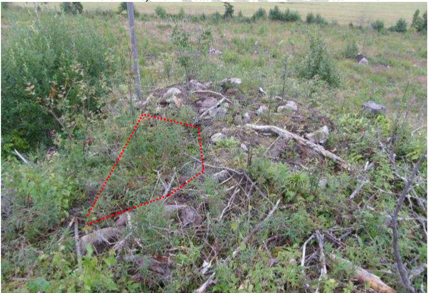
Kuva 18. Röykkiö 2 sijaitsee kallionkielekkeellä. Punaisella pisteviivalla on esitetty purettu tai romahtanut osa rakennetta. Kuva: Kalle Luoto 21.7.2011.
