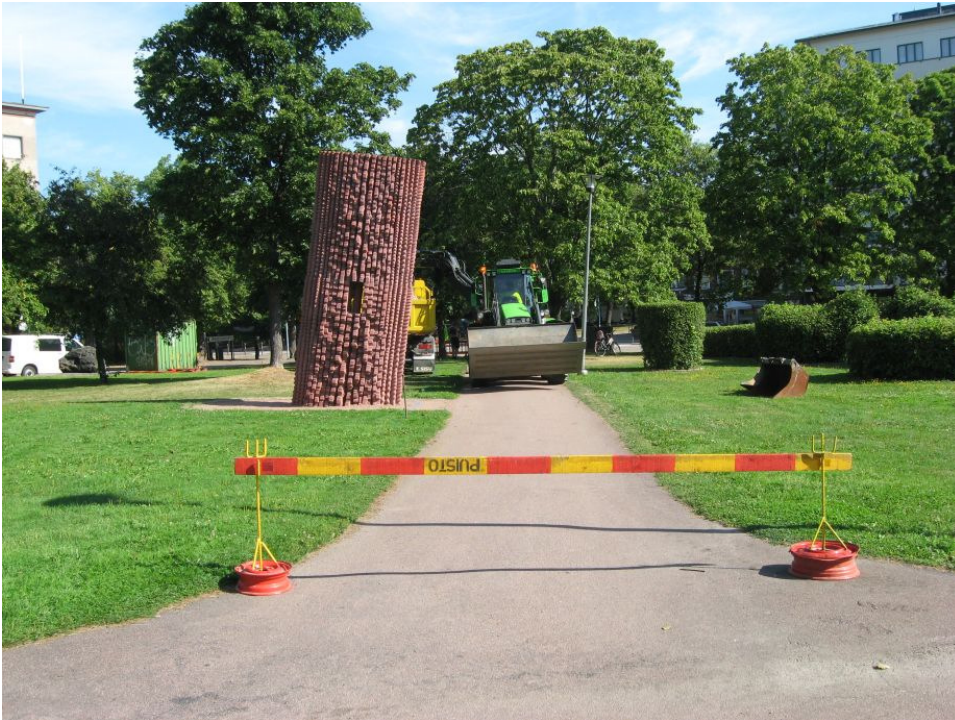
Kuva 7: Asfalttipäällysteinen käytävä 1 ennen saneerausta. Vasemmalla Federico Asslerin betoniveistos vuodelta 2005. S. Kuva: KyM/M. Kykyri.
