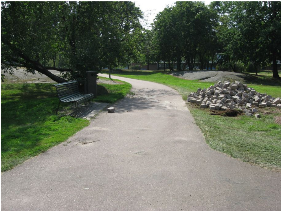
Kuva 12: Käytävä 3:n N-pää ennen saneeraustöiden aloittamista. Kuvan keskiosassa näkyy roudan asfalttipinnalla aiheuttamia vaurioita. N. KyM/M. Kykyri.
