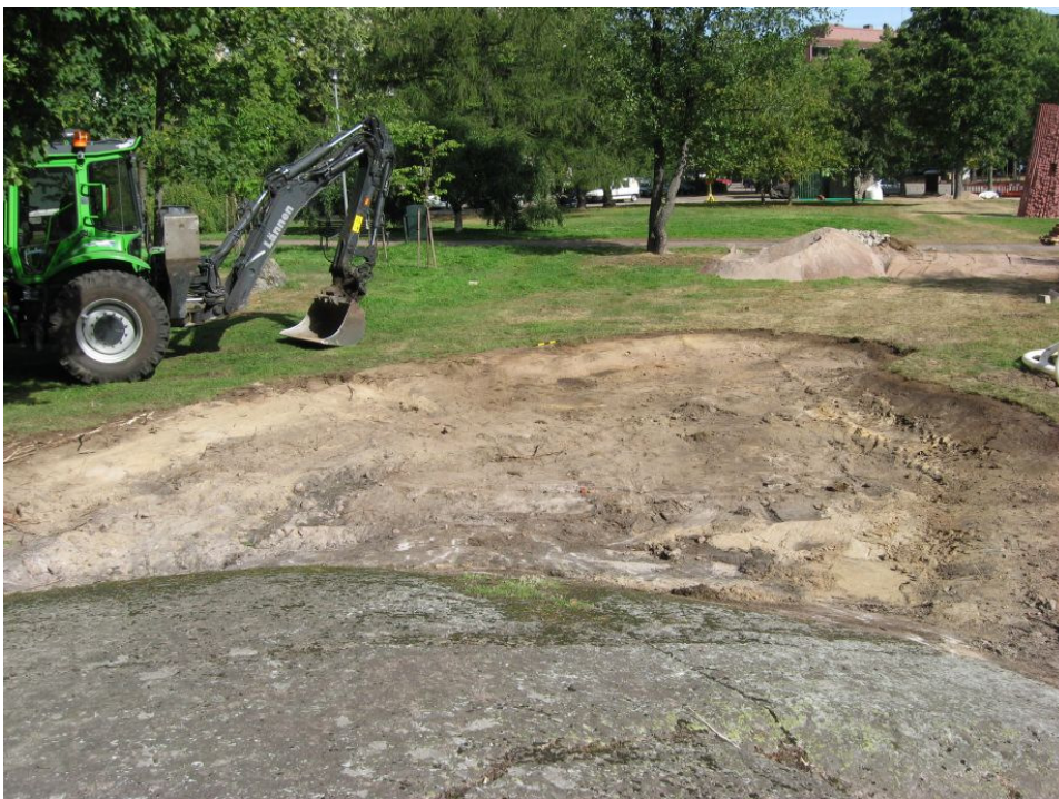
Kuva 14: Kosteikkoallas pohjaan kaivettuna. Altaan alueella oli säilynyt Ruotsinsalmen aikaista kulttuurikerrostumaa löytöineen, mutta se jätettiin maaperään paikoilleen lähes koskemattomana. S. KyM/M. Kykyri.
