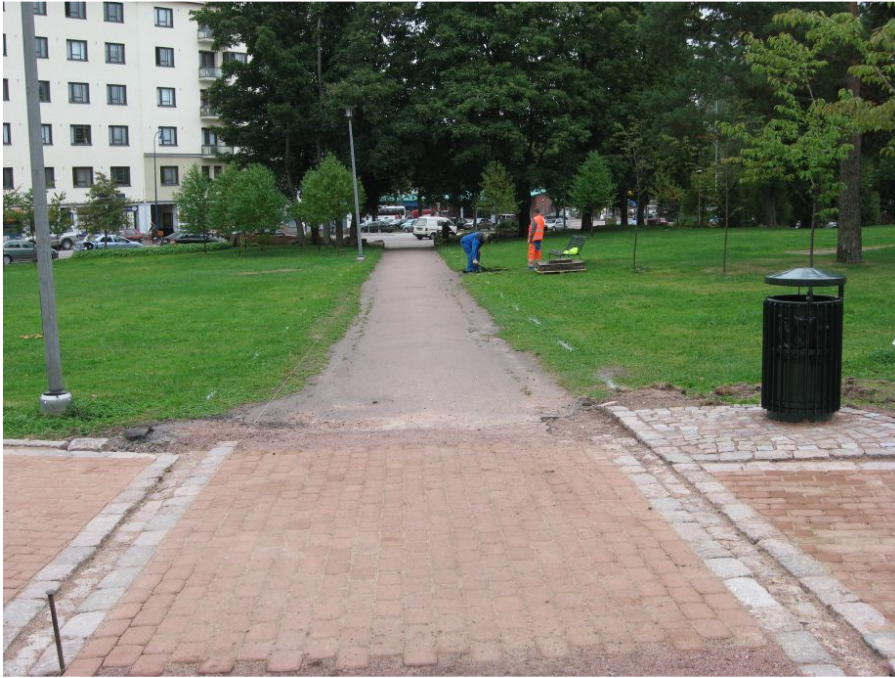
Kuva 20: Käytävä 2 ennen asfaltin poistoa. Oikealla saneerattu roskakorin paikka K 503. Taustalla J. Matilainen ja J. Uotinen poistavat puistonpenkin K 507 vanhaa betonitiilikatetta. W. KyM/M. Kykyri.
