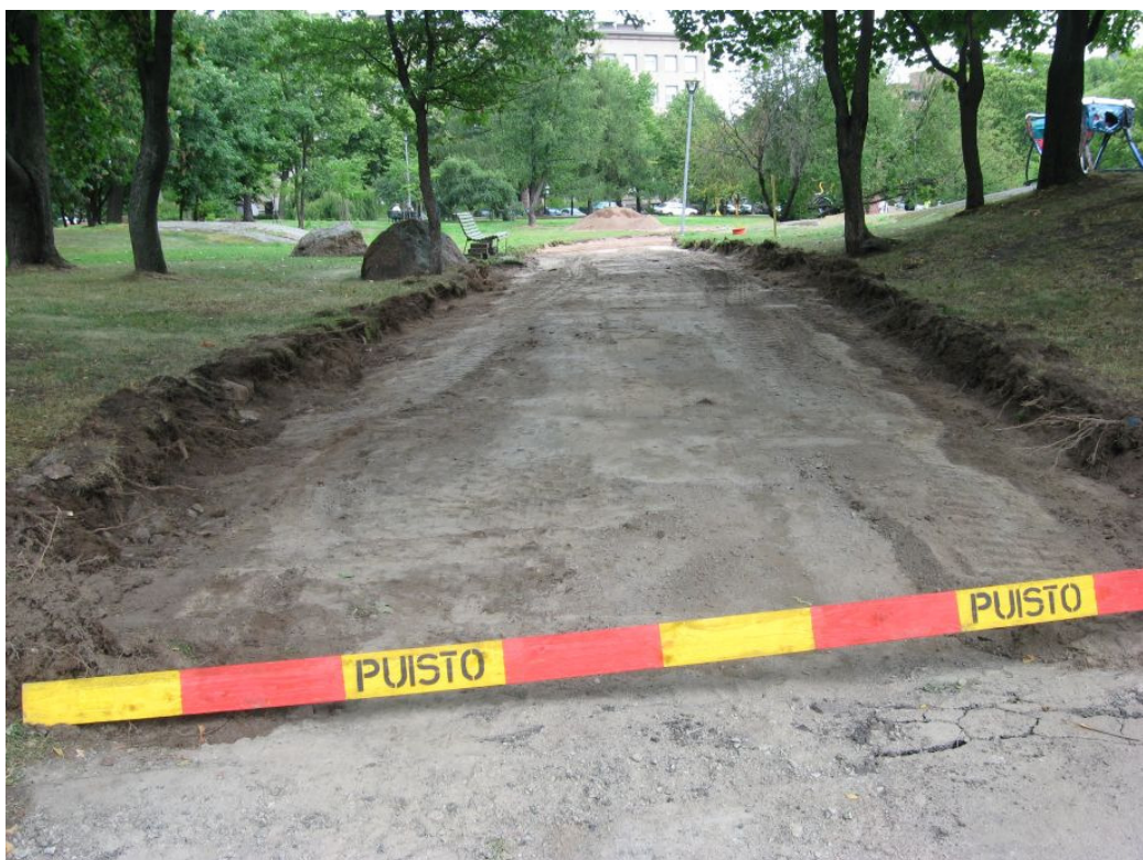
Kuva 13: Käytävä 3:n keskiosaa lopullisessa kaivussyvyydessään. Asvaltin alle levitetty vanha pohjustushiesu on jätetty paikoilleen ja ainoastaan puistokäytävän reunoja on levennetty ja syvennetty sinne asennettavien nupukivisten vesiurien vuoksi. S. KyM/M. Kykyri.
