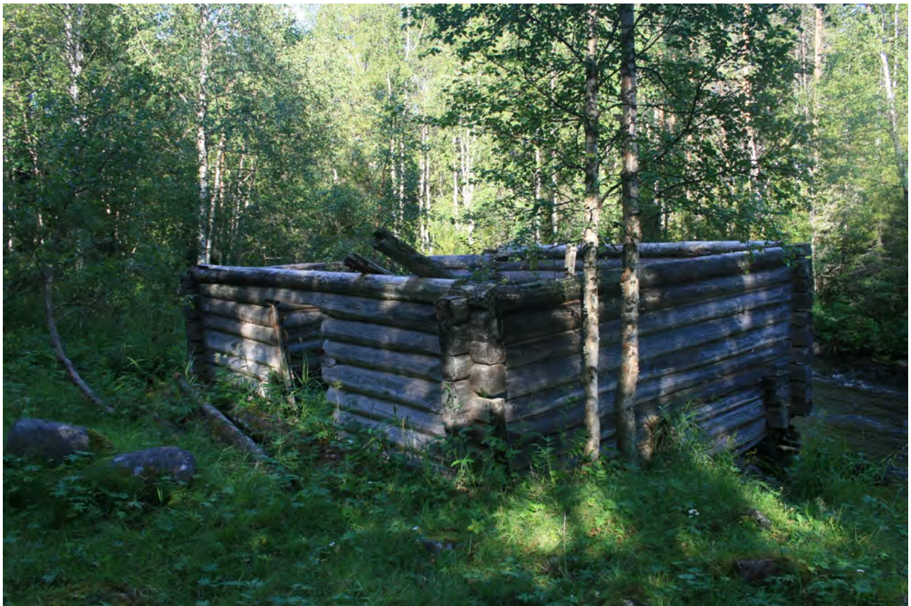
Kuva 20. Uusi kohde 5. Myllykoski, Naatikkajoki. Osittain sortunut myllyrakennus Naatikkajoen rehevällä luoteisrannalla. Kuvattu lounaasta.
