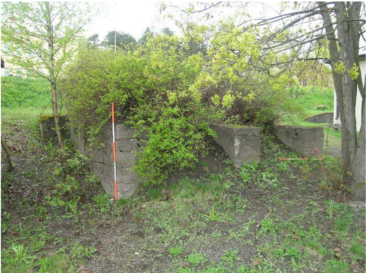
DSCN0300.JPG Pispalan tukkitie 1, betonirakenne. Lounaasta. 7.5.2008, Vadim Adel.
