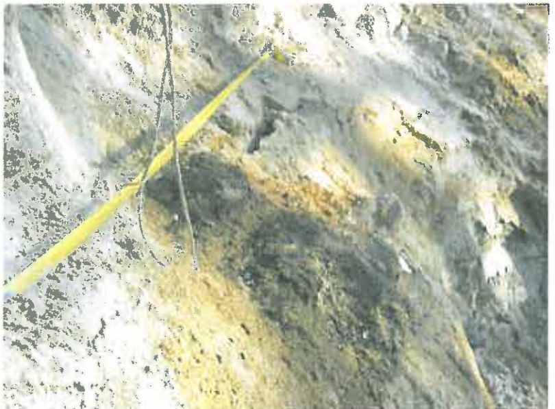
Irtoamassa olevaa seinämää.
