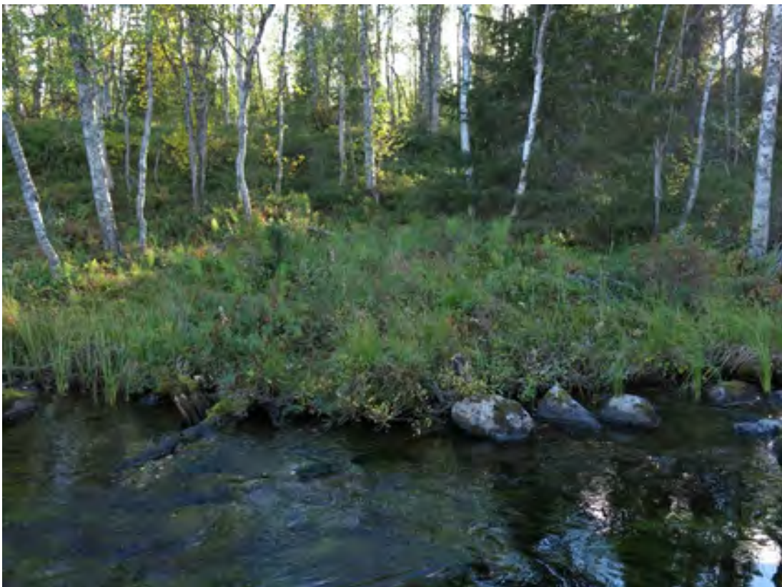
Kuva 363. Kopsusjärven uittopato. Patorakenteita joen lounaisrannalla. Maasta ja kivistä kasattu valli ja vallin tukipaalutusta. Kuvattu koillisesta.
