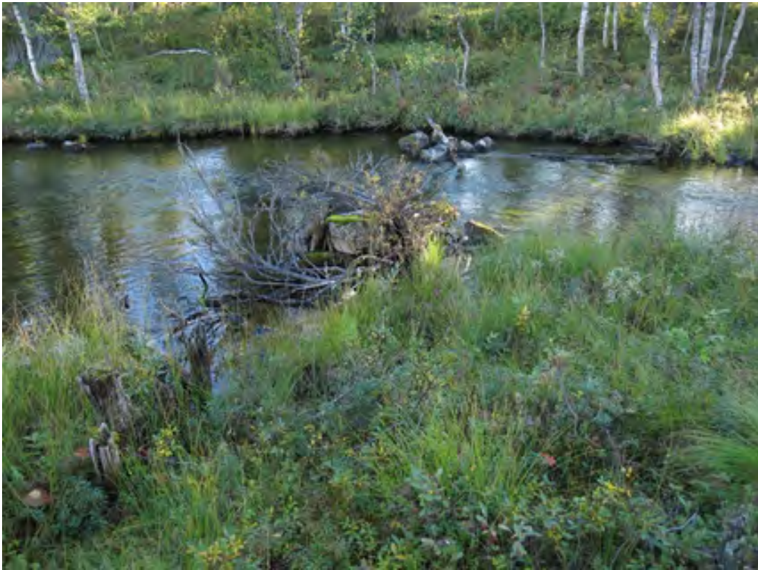
Kuva 362. Kopsusjärven uittopato. Padon viistotukien tukirakenteita. Etualalla rannassa paalutuksia, taaempana kivilatomukset. Kuvattu pohjoiskoillisesta.
