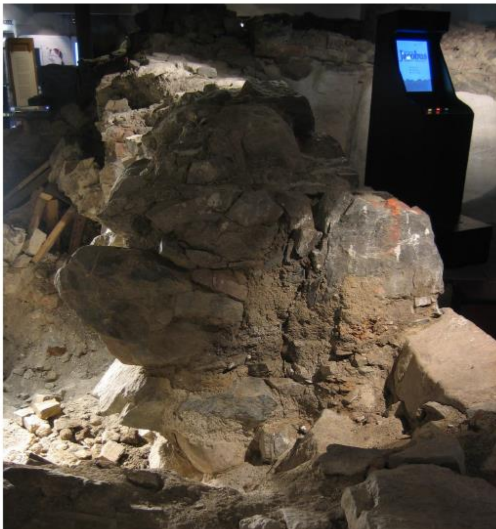
Kuva 3. Kuva 3 on otettu kuvassa 2 vasemmalle jäävästä kellarin seinämuurista. Kuvassa näkyy seinän yläosan rakenteen poikkileikkaus. Seinä on muurattu lähes kokonaan isoista luonnonkivistä ja siinä vaikuttaa olevan täyteenä erittäin haurasta laastia ja hiekkaa. Mikäli tämä "hiekkä sydän" on ainoa muurin sisärakenne, on mahdollista että muuri repeää ja halkeaa kahtia. Mikäli näin käy, muurin vasen puoli (kuvassa) sortuu kaivausalueelle. Katsi myös kuva 4, joka selventää muurin rakennetta.
