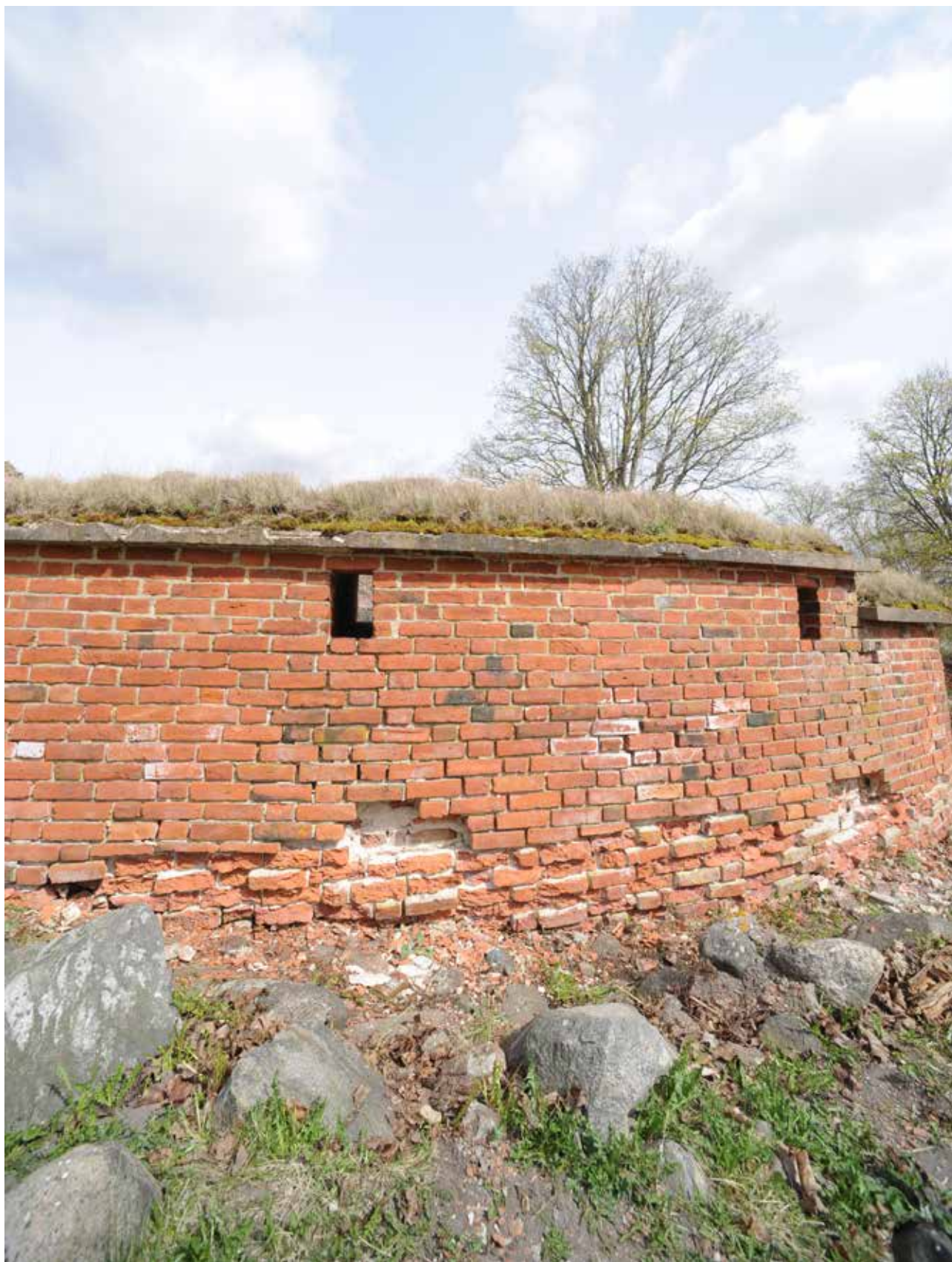
Kuva 2. Eteläisen esilinnan ulkomuuri keväällä 2014. Vaurioituneet kohteet. Rapautumakohde 2 kuvassa etualalla ja kohde 1 kuvassa oikeassa reunassa. YK. SW. KU.
