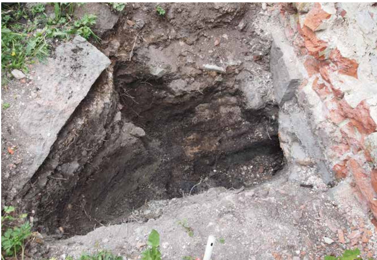
Kuva 11. Eteläisen esilinnan ulkomuuri keväällä 2014. Vauriokohde 1 ja tutkimusalue 2014_2 länsiprofiili. E. KU.
