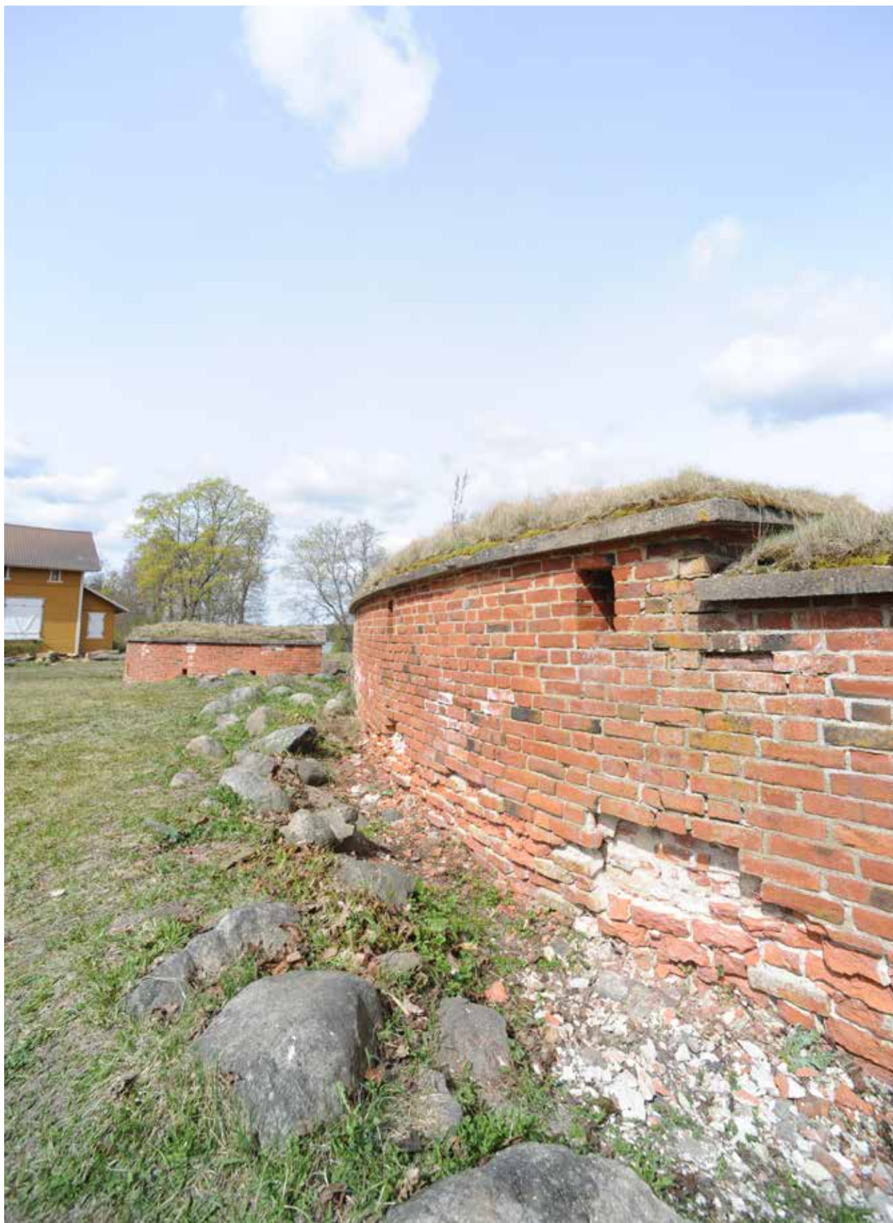
Kuva 3. Eteläisen esilinnan ulkomuuri keväällä 2014. Vaurioituneet kohteet. Rapautumakohde 1 kuvassa oikeassa reunassa. YK. SE. KU.
