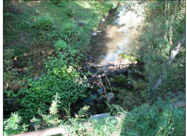
Osin tuhoutunutta betonista valmistettua tulvapatoa vanhan kivisillan pohjoispuolella.
