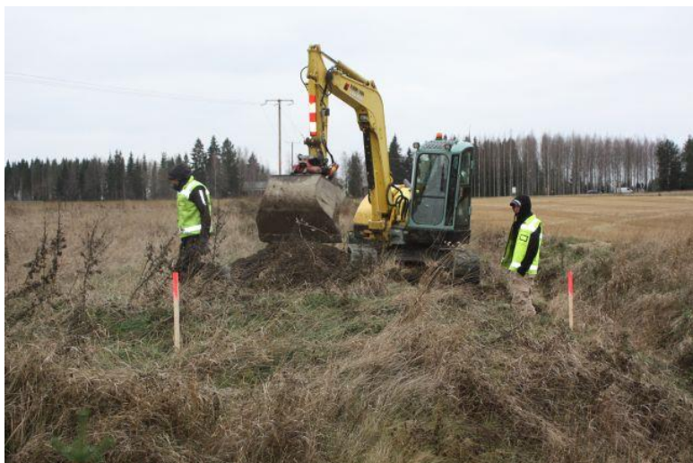
AKDG3900:16 Työkuvaa. Pentintien eteläreunalla kulkevaa viemäriinjaa kaivetaan. Kuvassa vasemmalla Petri Suomala ja oikealla Olli Eranti. Pohjoisesta. Kuva Esa Mikkola, Arkeologiset kenttäpalvelut 23.10.2014
