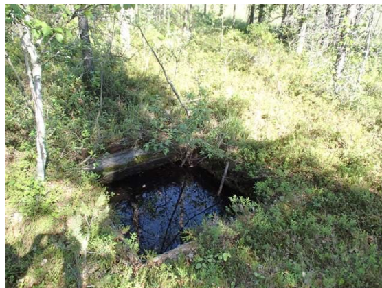
Kaivon kansi on lahonnut, kuvattu itään.
