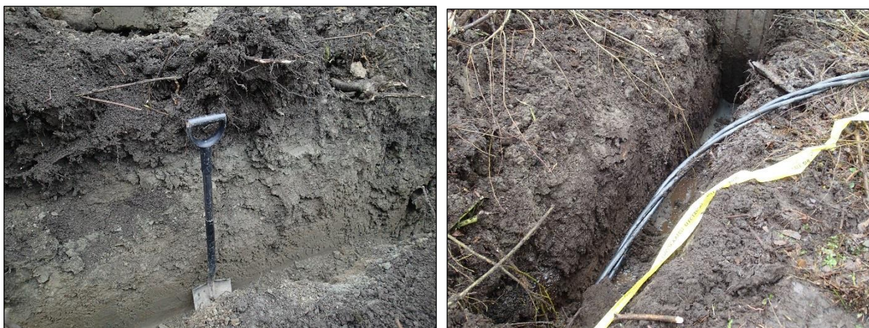
Maakaapeliojan kostea ja savista länsipäätä.
