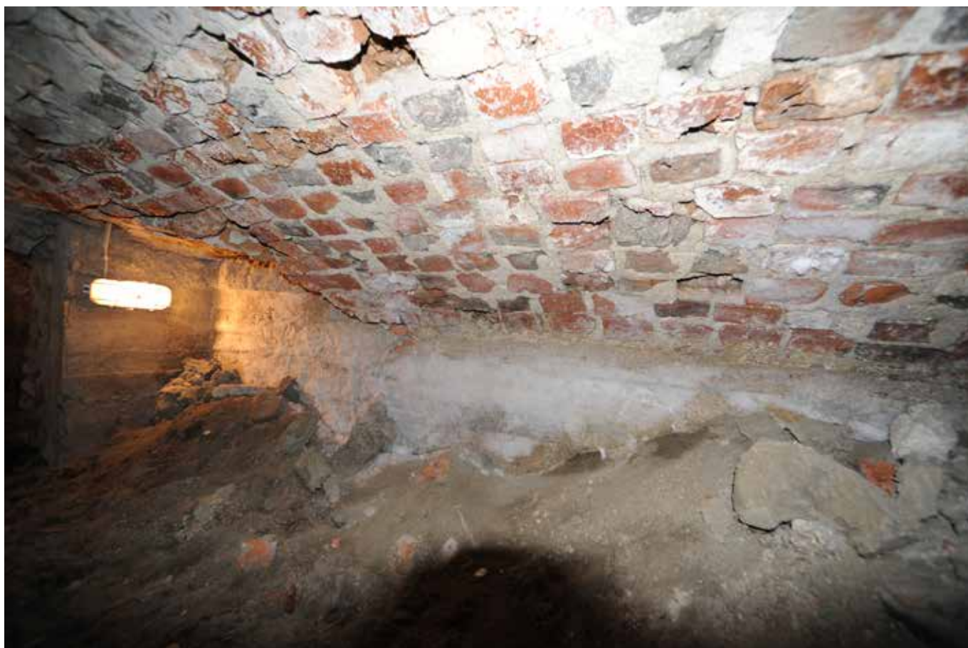
Kuva 23. Kellari 017 laaja suola-alue rakenteissa.
