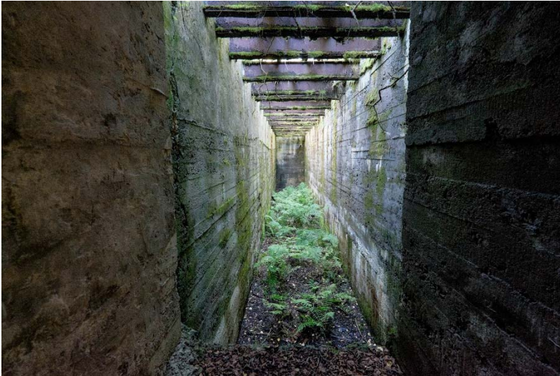
AKDG 4500:7. Isosaari 1. Keskussähköaseman lännen puoleinen huone. Kuva pohjoisesta. Kuvaaja: V. Laulumaa.
