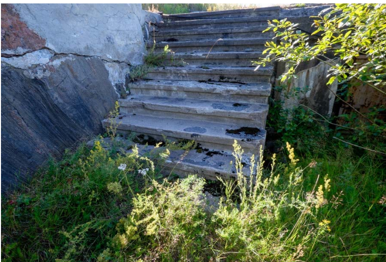
AKDG 4500:101. Isosaari tykkipatteri A. Kasvillisuus alkaa valloittaa osaa patterista ja rakenteet rapautuvat. Kuvaaja: V. Laulumaa.
