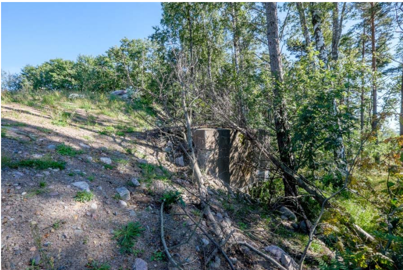
AKDG 4500:14. Isosaari 2. Betonikasematti on osittain ampumaradalta työnnetyn maa-aineksen peitossa. Kuva luoteesta. Kuvaaja: V. Laulumaa.
