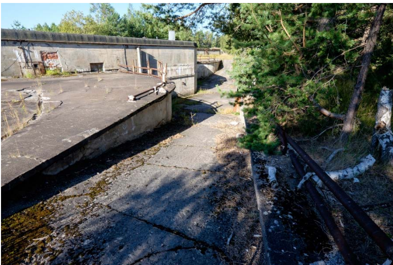
AKDG 4500:102. Isosaari tykkipatteri A. Patterin ajorampit ovat lohkeilleet ja kaitteet hajonneet. Kuvaaja: V. Laulumaa.
