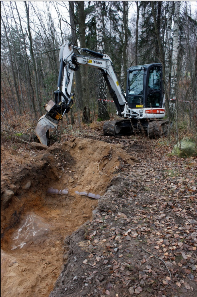
Kuva 13. Koeoja 2. Puhelinkaapeli, jonka asennustyö on aikanaan tuhonnut tien koillisreunan, on tullut näkyviin. Kuva: John Lagerstedt. Museovirasto, 2015. AKDG 4596:13.
