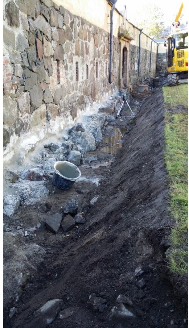
AKDG 4604:43. Valmista puhdistettua läntistä kaivantoa, seinää on tiivistetty betonilla, länteen. Kuvaaja: Johanna Seppä.
