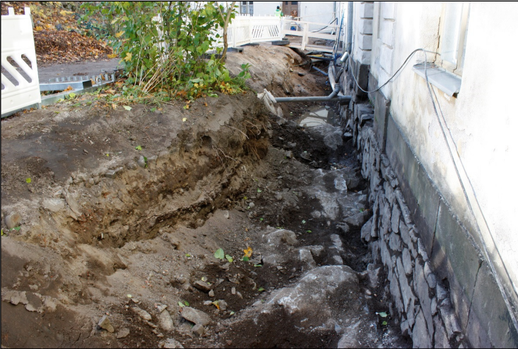
Kuva 5. Pihan itäosan kaivutyöt ovat valmistuneet. Vasemman puoleisessa profiilissa näkyy kenttäkiveystä. Kuvattu kaakosta. AKDG4598:8.
