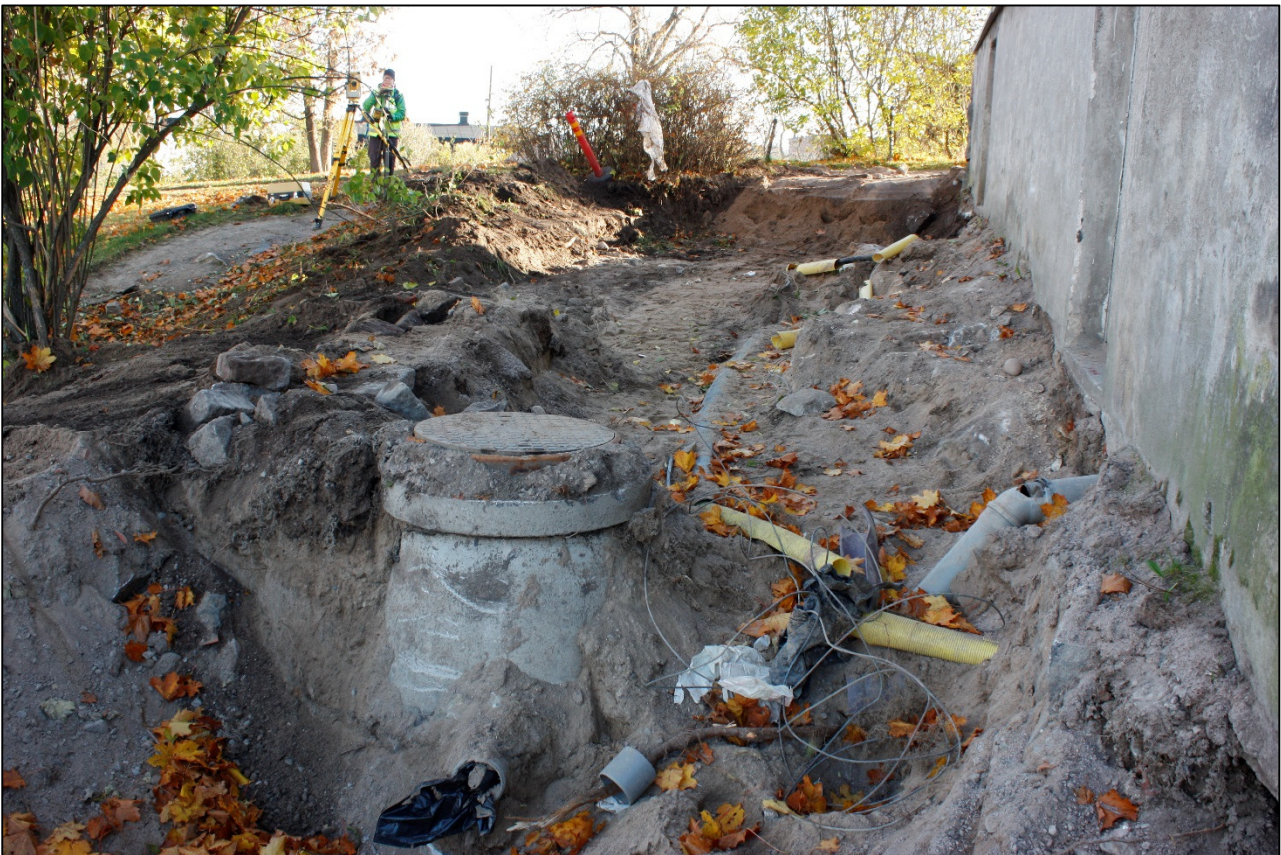
Kuva 4. Työmaakaivanto on lopullisessa syvyydessä ja leveydessä. Johanna Seppä kartoittaa aluetta takymetrillä. Kuvattu luoteesta. AKDG4599:4.
