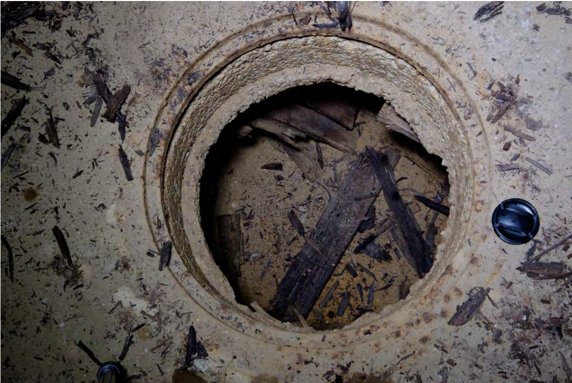
Kuva 21. Sulkuhuoneen kokoajakaivo. (AKDG4603:21)
