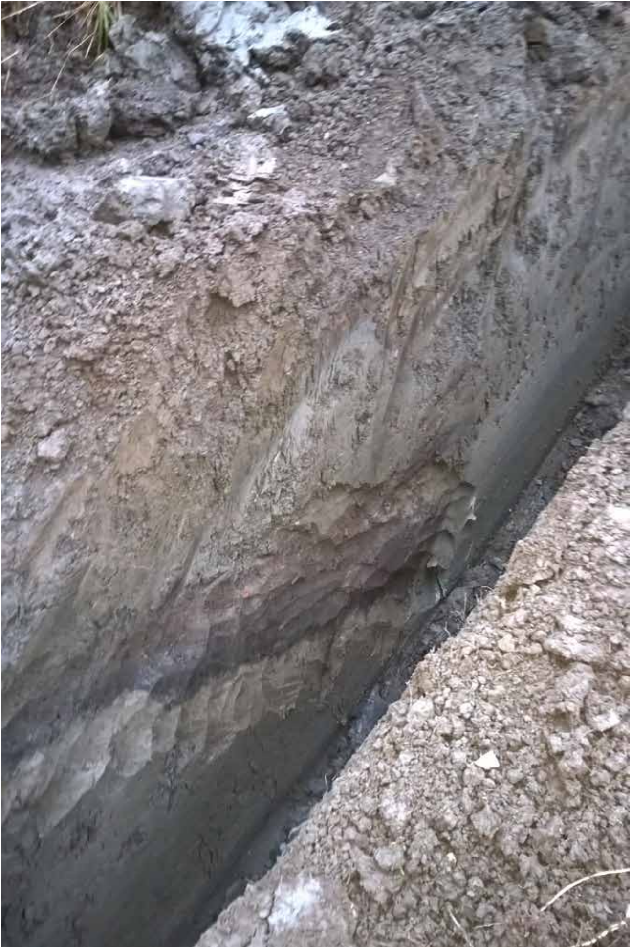
Kuva 3. Alueen 2 vanhempi oja ja siihen liittyvä maakerros. Kaakkoinen profiili. N. K.Uotila. Marraskuu 2015.
