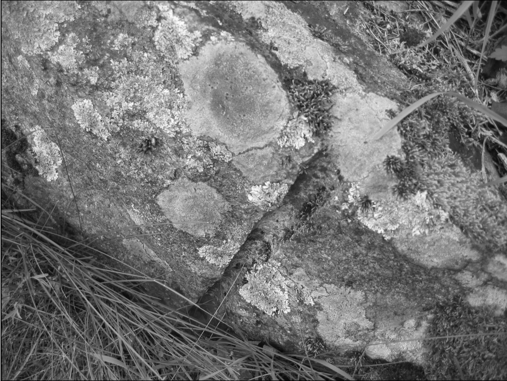
Kuva 20: yksityiskohta kivijalasta. Porausjälki perustuskivessä. Digikuva. Kaakosta. 1.8.2007.
