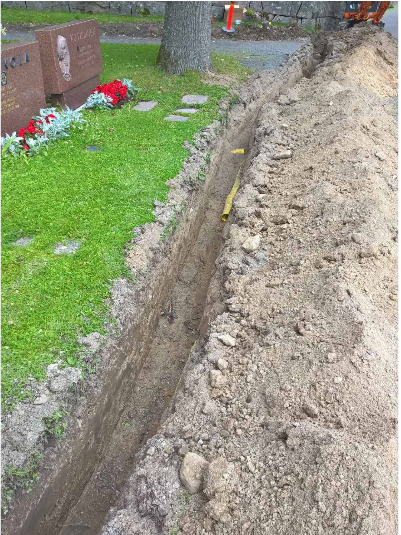
Kuva 1. Kirkon itäpuolen kaivanto. Kapea sähkökaivanto, joka rajoittuu selvään hiekkamaatäyttöön. Kuva 27.7.2015. K. Uotila / Muuritutkimus ky.
