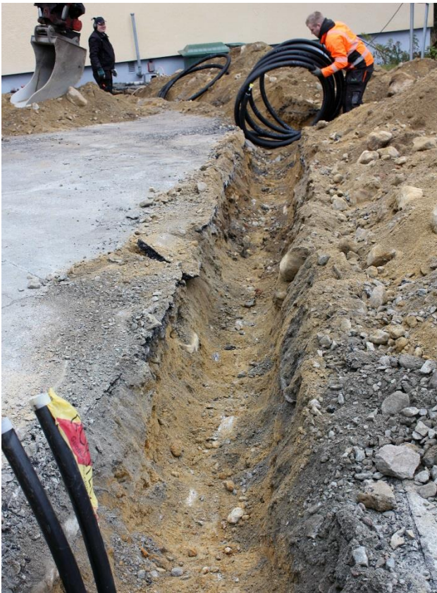
Kuva 11. Kerrostalon eteläpuolelle kaivettu putkioja, jossa täyttömaata oli ojan pohjaan saakka. Kuvattu lounaasta. AKDG 4691:7
