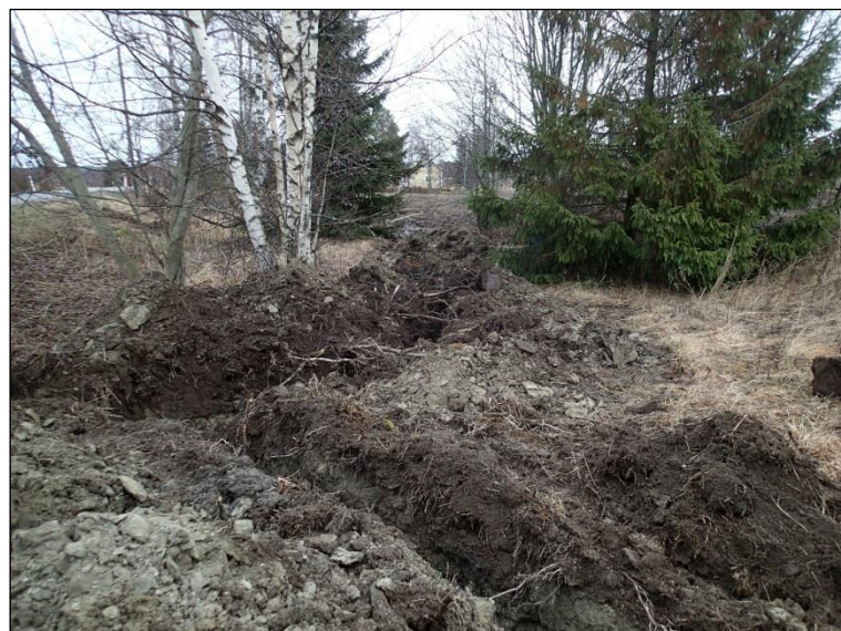
Pihatien itäpuolen kaapeliojaa ja haaraumakohta tiealituksen kohdalla.
