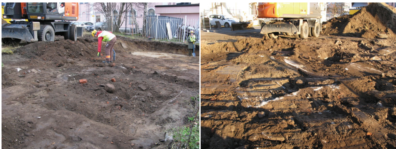
Vasemmalla SY2 purkukerroksen poistoa Välikadun varrella. Kuvan oikeassa reunassa erottuu paikoillaan ollut betonianturan R7 osa. Oikealla Eliksenkadun varren purettuun talon yhä paikoillaan ollut betonilattian osa kerroksessa SY2. AKDG4495:10 ja 42
