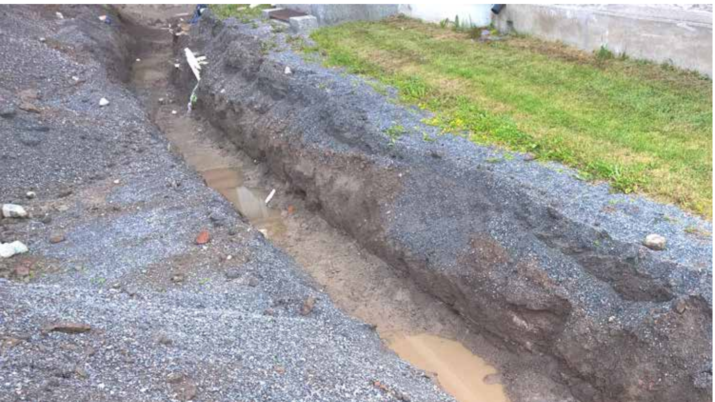
Kuva MuTu116006:3. Kaivannon luoteisen osan koillisprofiili, jossa esillä eri aikaiset täyttökerrokset. S. KU. Kesäkuu 2016.
