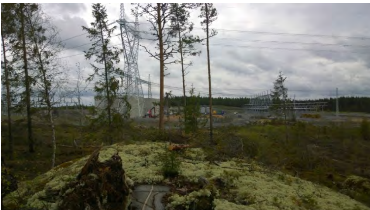
AKDG 4698:14. Jylkän sähköasema, linjan päätepiste. Kuvaaja: Petro Pesonen.
