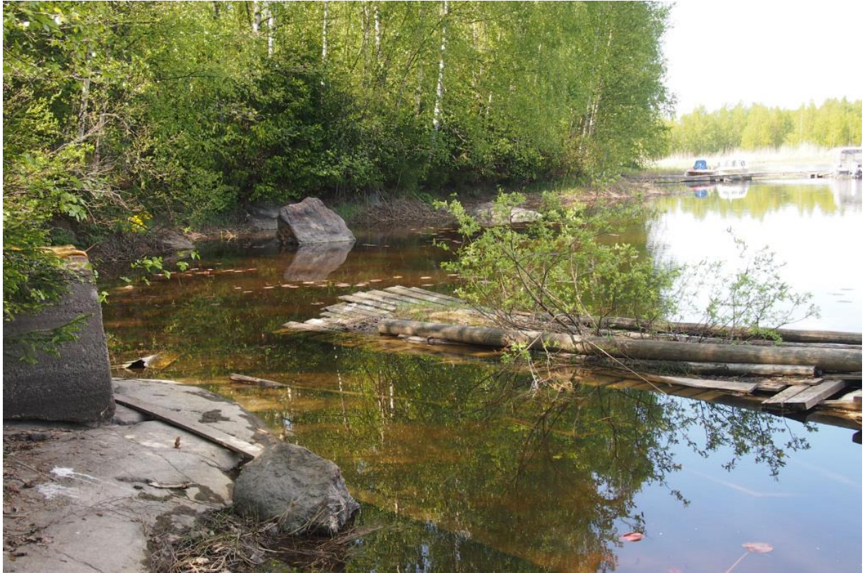
Kuva 2. Salminiemenkärjen itäpuolella käytössä oleva pienvenelaituri kuvan oikeassa ylälaidassa. Sortunut laiturin ja laiturin betonituki etualalla. Kuva kohti luodetta. © Rami Kokko / ARK-sukellus.
