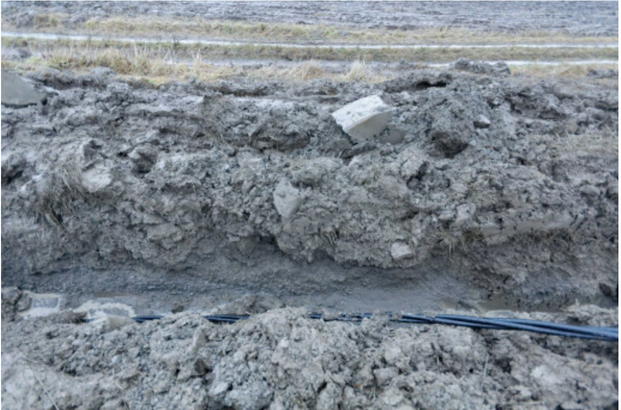
Kuva 4. Kaapelikaivantoa Lehden alueella lähellä Lehden asuinpaikkaan liitetyn oikokirveen löytöpaikkaa. Savisen, noin 30-40 cm syvän viljelykerroksen alla on koskematon pohjasavi.
