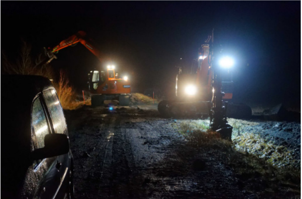
Kuva 1. Linjan 1 (Kaivonpyöli) läntinen alkupää Kaivonpyölintien varressa ennen kaivutöiden aloittamista. Kaapeli oli alunperin tarkoitus asentaa maahan ns. auran avulla, mutta sateen pehmentämän maaperän vuoksi kaivutyö jouduttiin tekemään pääosin kauhalla.
