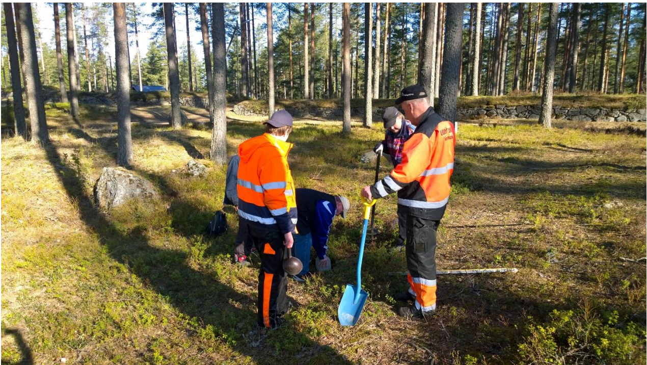
Kuva 1. Luumäen kunnan työntekijät sovittavat opasteen betonijalustaa vastakaivettuun asennusmonttuun Taavetin linnoituksella. Kuva: Satu Koivisto/ARKE (AKDG 5037:2).
