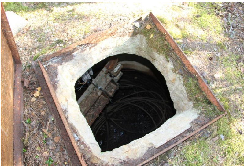
AKDG 4877:155. Itä-Villinki, kaapelikaivo. Kuvaaja: J. Lagerstedt.
