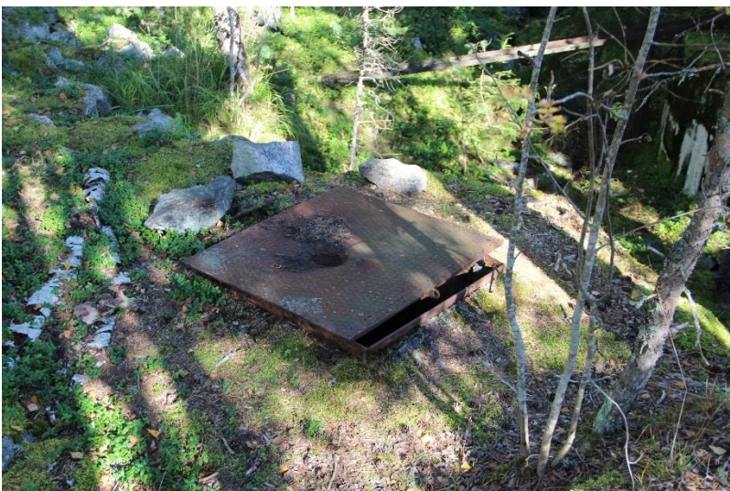
AKDG 4877:157. Itä-Villinki, kaapelikaivo. Kuvaaja: J. Lagerstedt.
