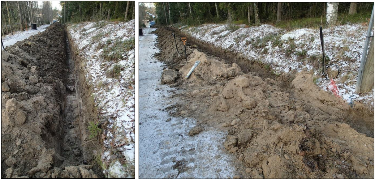
Vasen kuva: kaivannon itäpää (80 cm:n syvyyteen kaivettu osa). Itäkaakosta. Oikea kuva: yleiskuva linjasta valvonnan päättyessä. Kaakosta.
