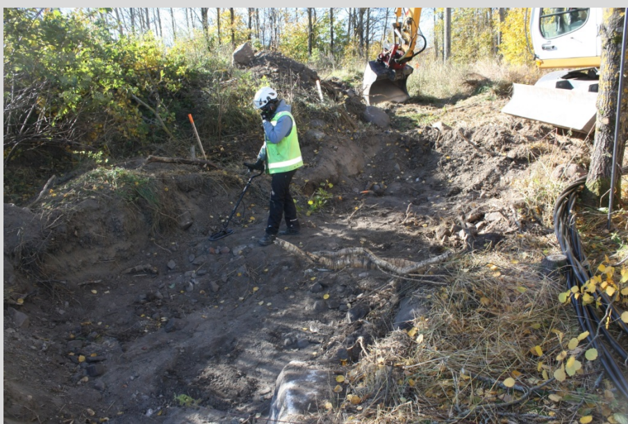
AKDG 4876:11. Saaren kartano. Työkuva. Tuija Väisänen tutkii puistomuuntajan kaivantoa metallinilmaisimella. Etualalla kaivannon pohjassa hiilistä maata. Koillisesta. Kuvaaja: Johanna Seppä.
