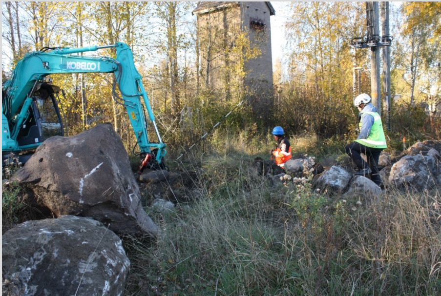
AKDG 4876:19 Saaren kartano. Työkuva. Suuria kivenjätkäleitä nostetaan kaivannosta pylväsmuuntajan ja tieuran välissä. Etelästä. Kuvaaja: Johanna Seppä.
