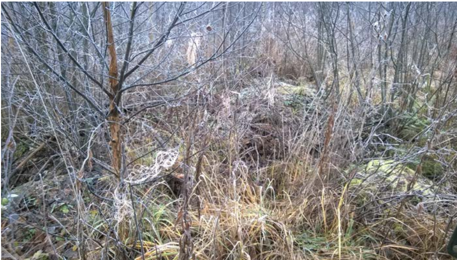
AKDG 5043:55. Rantalan torppa. Taka-Rantalan piha-piirin lounaispuolella oleva kivijalka heinikon ja vesakon peitossa, etelästä. Kuvaaja: Tuija Väisänen.
