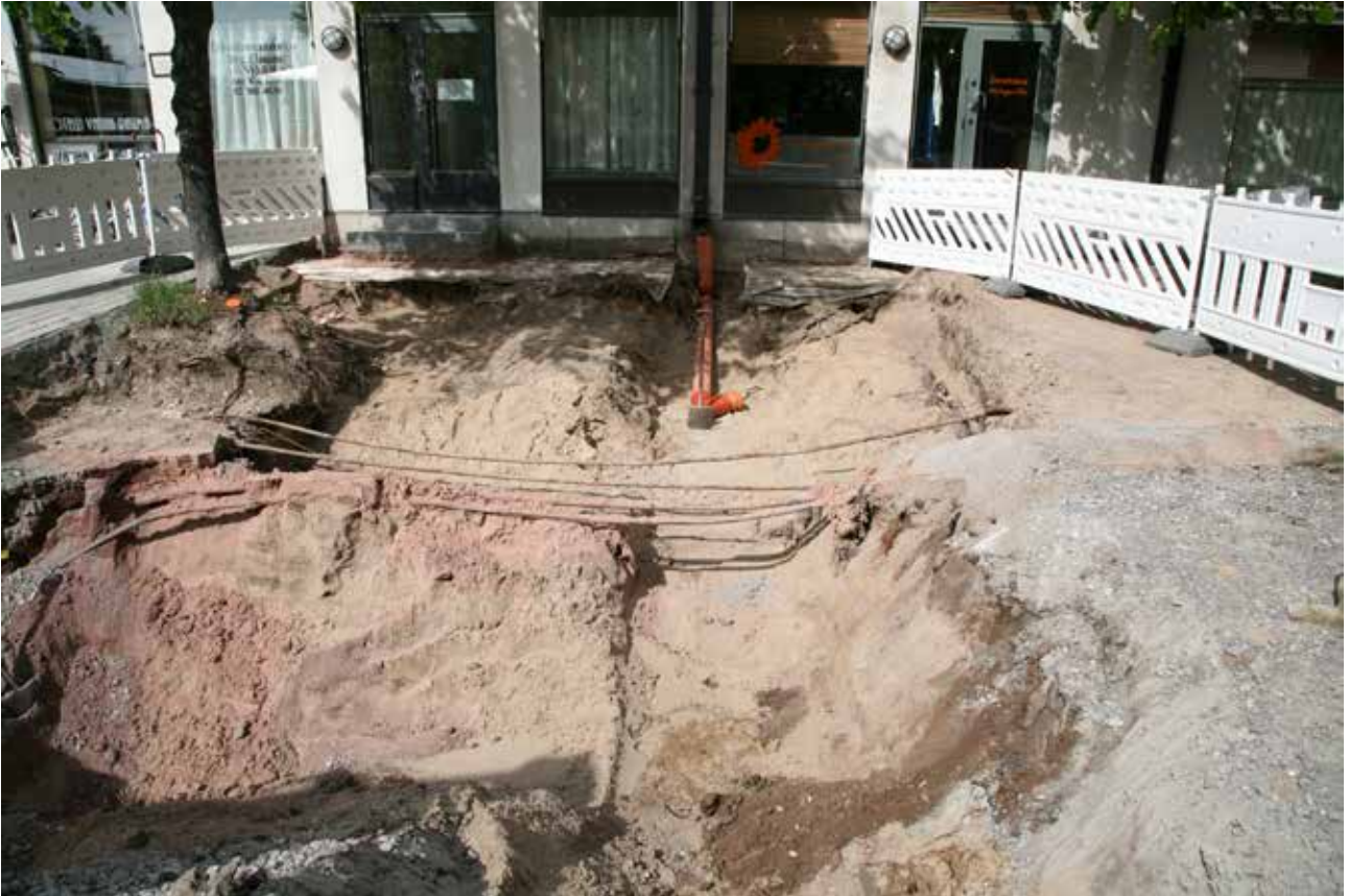
MuTu116012Dg_8. Alue 7. Vanhankirkonkadun pohjoispuoli. Kulttuurikerrokset tuhoutuneet jo aiemmissa putkitöissä ja maansiirroissa. 7.6.2016. Etelästä. J. Haarala.
