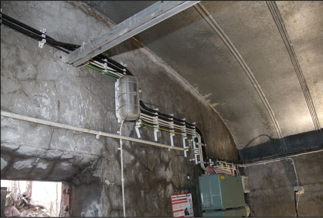
Kuva 12. Luolan G6 eteinen lounaan suuntaan kuvattuna. Katon alkuperäiset aaltopellit on poistettu ja korvattu uusilla. Luolan sähkölaitteet on myös uusittu myöhemmin. AKDG49189:12.
