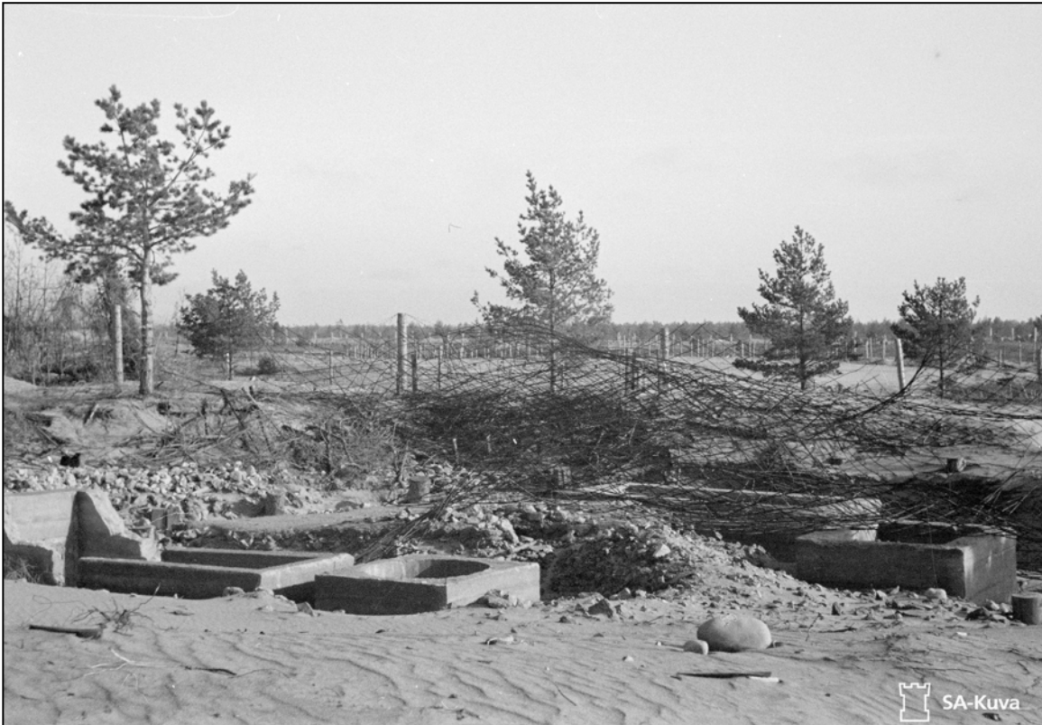
Kuva 11. Keskenjäänyt betonibunkkerin rakennustyömaa Lappohjassa lokakuussa 1942. Kuopan pohjalle on ehditty valaa betonisia kaivorakenteita ym. Kuopan reunalla on betonivalujen vahvistamiseen tarkoitettua pyöröteräsverkkoa. SA-kuva 114156a. Alarik Öhrnberg, 1942.
