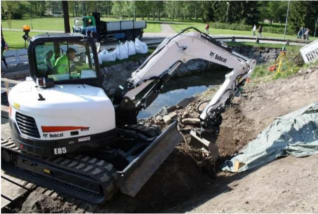
AKDG4721:9 Maavallista poistetaan pintakerroksia kaivinkoneella. Konetyö Kasanko kaivaa. N-S. Kuva Katja Vuoristo. Kuva Katja Vuoristo.
