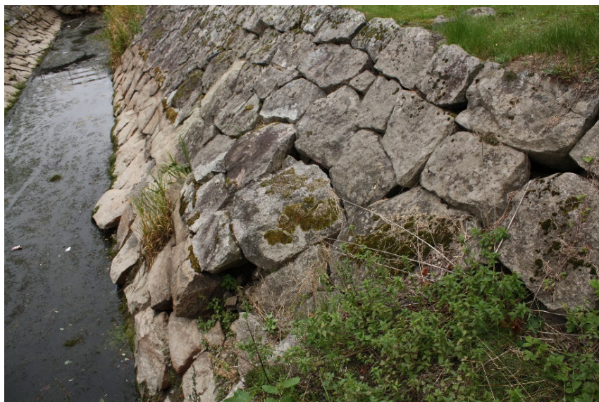
AKDG4721:65 Eteläisen sillan länsipuolen eskarppimuurin korjausalue ennen kivien poistoa. Vauriokohta erottuu muurissa selkeänä pullistumana. NE-SW. Kuva Katja Vuoristo.
