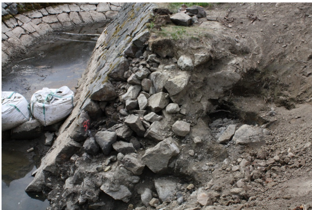
AKDG4721:53 Koekorjausalueen eskarppimuurin länsiprofiili. Muurin tauksen kivet on purettu jo osittain, mutta niiden kohdalla erottuu vielä kivistä saveen jääneet kuopat. NE-SW. Kuva Katja Vuoristo.
