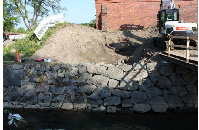
AKDG4721:16 Eskarppimuuri ennen purkamista, maavalli on viistottu A-insinööri Suunnittelu Oy:n ohjeiden mukaan. SE-NW.
