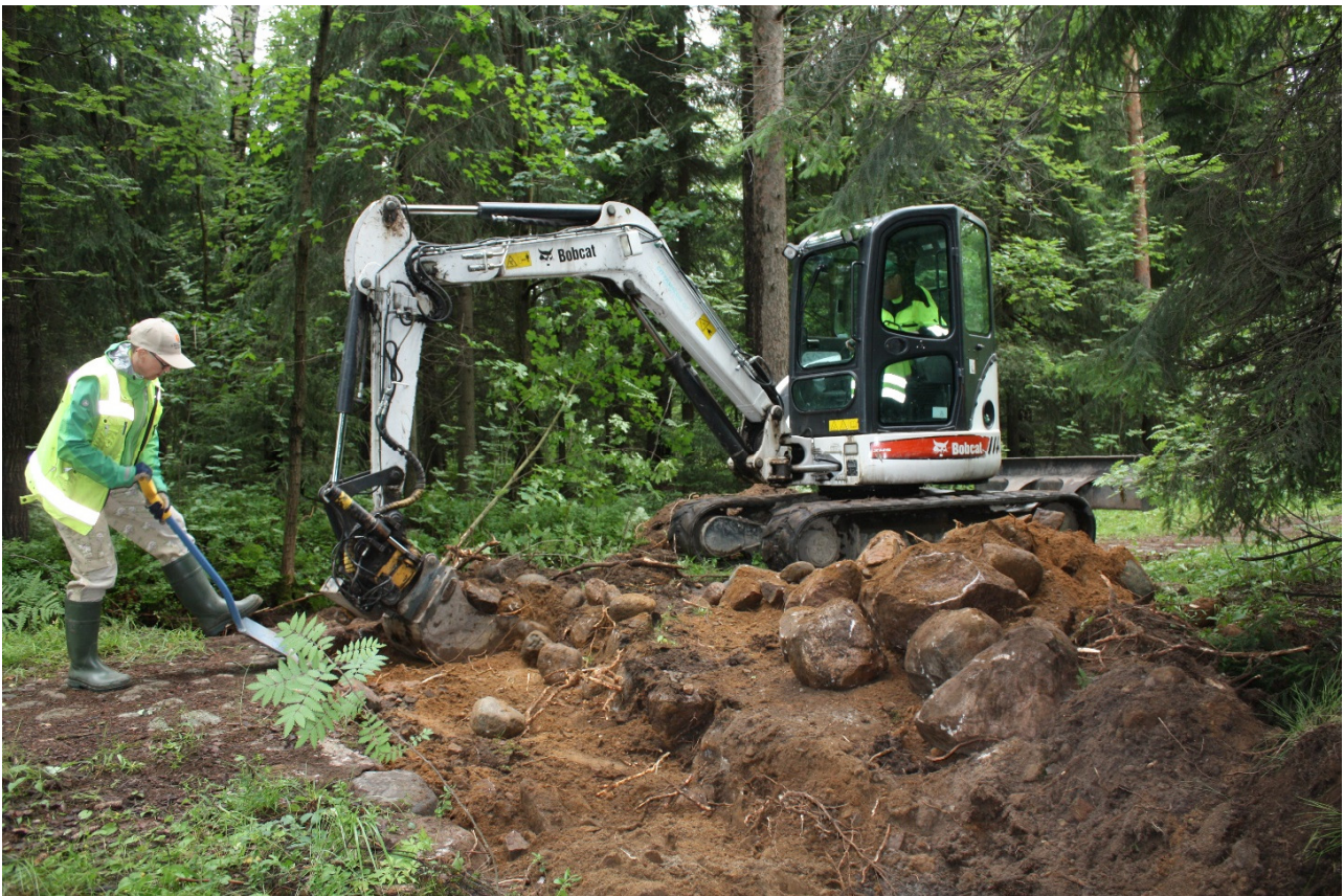
AKDG5192:8 Koeajaa 1 avataan kaivinkoneella. Apulaistutkija Johanna Seppä suorittaa poikkileikkauksen dokumentoitavaa profiilia. Kuva Katja Vuoristo.
