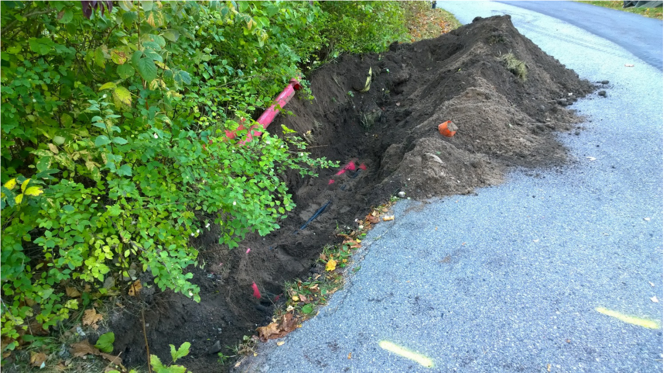
Kuva 4. Kaapelikaivannon pohjaa Pappilanmäen kaakkoisreunalla, jonka pohjalla kulki vanhoja kaapeleita. Kuva: Satu Koivisto/ARKE (AKDG 5202:2).
