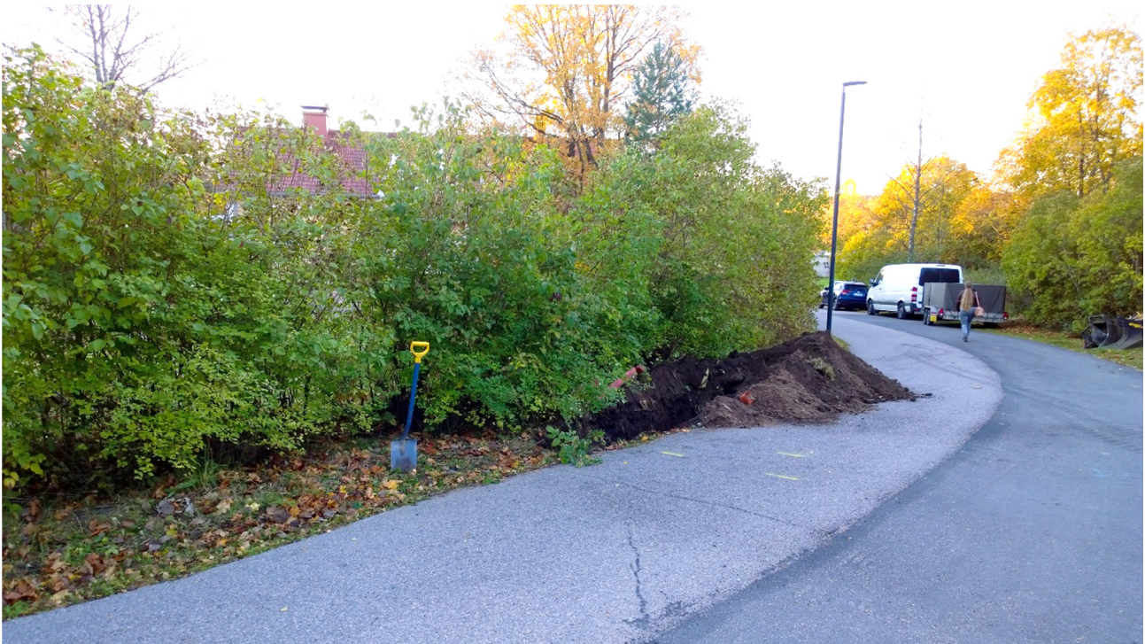
Kuva 3. Kaapelinvetomonttua Pappilanmäen tien kaakkosreunalla. Pensaiden takana häämöttää pappilarakennuksen punainen katto. Kuvattu kaakkoon. Kuva: Satu Koivisto/ARKE (AKDG 5202:3).
