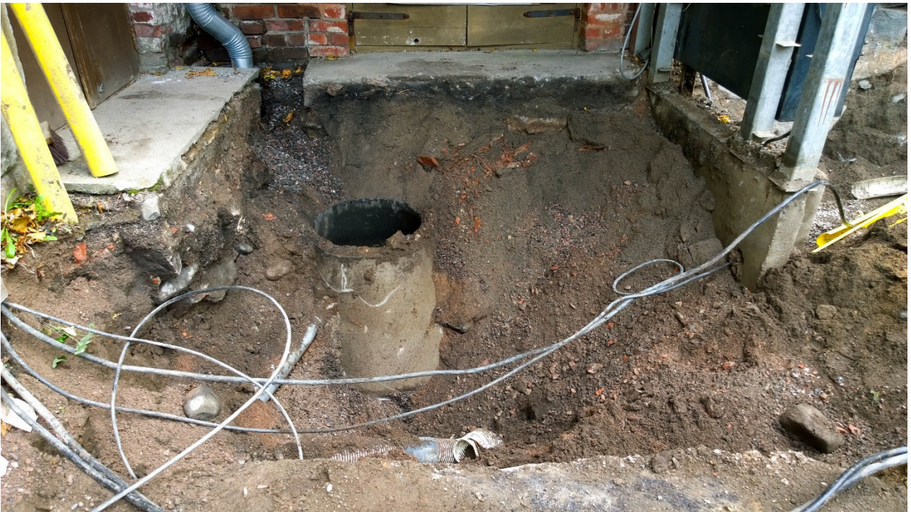
Kuva 6. Vanha viemärikaivo ja uuden asennusmonttu paljastettuna sisäänkäynnin edustalla. Kuvattu itäkaakkoon. Kuva: Satu Koivisto/ARKE (AKDG 5204:8).
