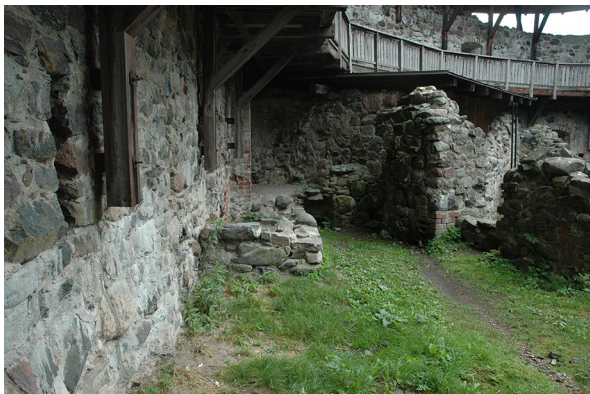
3. Alue 9A. Alue 9A ennen kaivausta. Etualalla koekuopan 9A paikka ja sen takana muurattu perustus (R9A-9). SSW-NNE. TK.
