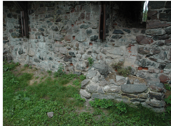
4. Alue 9A. Alue 9A ennen kaivausta. Etualalla oikealla koekuopan 9A paikka. E-W. TK.
