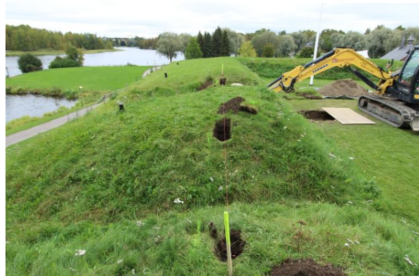
AKDG5378:89. Hämeen linnan pyörötornin eteläpuolisen tykkitasanteen koekaivausalue. Ampuma-aukkoihin tulevien kaiteiden pylväiden paikat. Kuvattu luoteesta. Kuvaaja Esa Mikkola.
