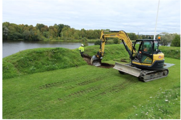
AKDG5378:79. Hämeen linnan pyörötornin eteläpuolisen tykkitasanteen koekaivausaluetta avataan kaivinkoneella. Kuvattu luoteesta. Kuvaaja Esa Mikkola.
