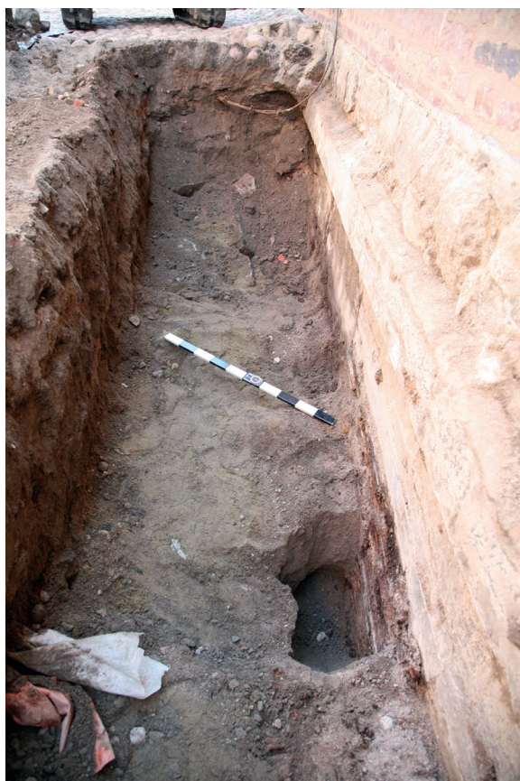
MuTu118018_3. Kaivannon pohja (tarvittava syvyys) sekä seinän vieren tehty koepisto. Lounaasta. 26.6.2018 Janne Haarala.
