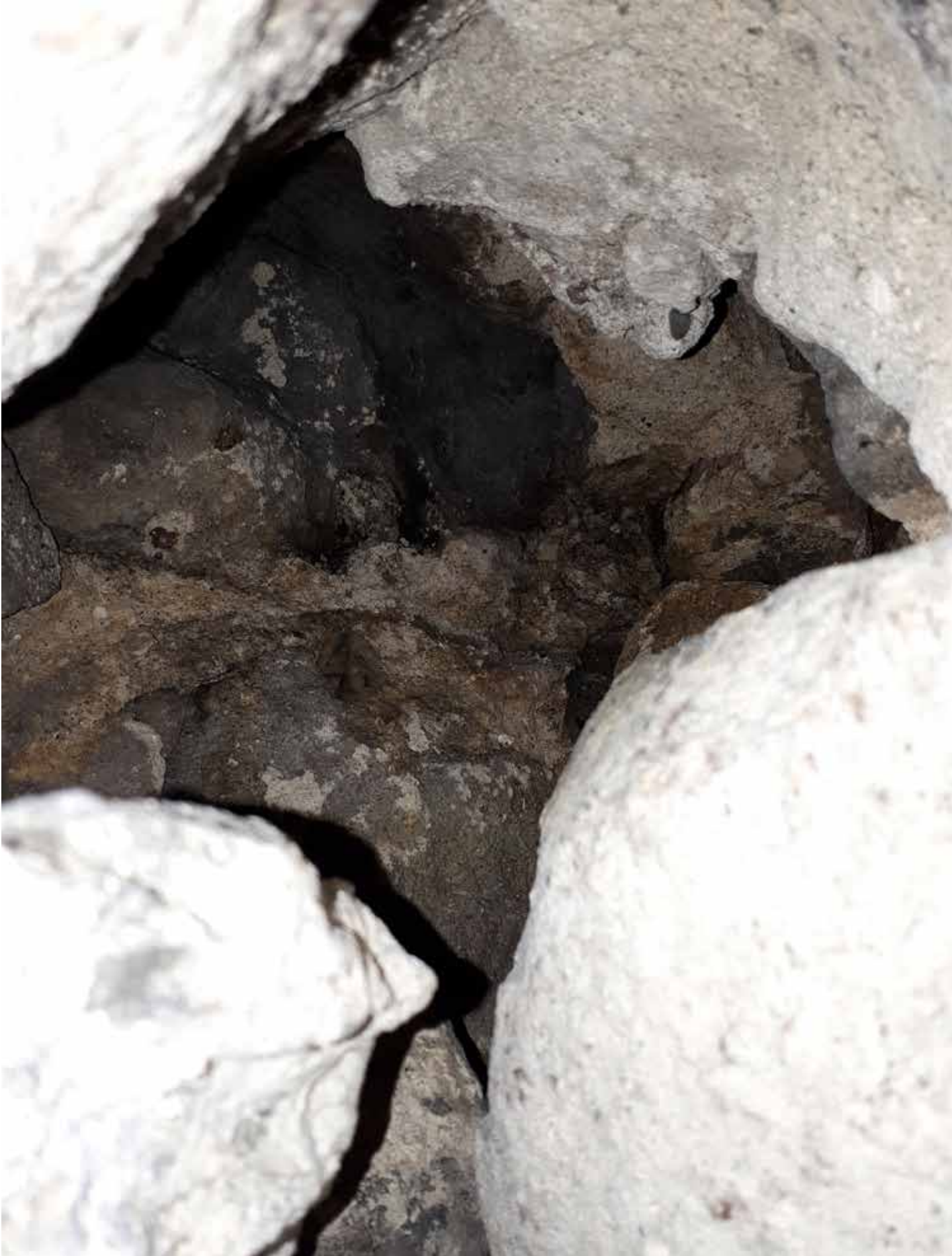
Kuva 8. MuTu218001:8. Telinetaso 2. keskiosa nro 14. Kaksiosainen muurin avausaukko, josta havaittiin multamaata. Yläosasta tuli esiin n. 45-50 cm:n syvyydeltä vanhempi muurirakenne. KU. Joulukuu 2017. W
