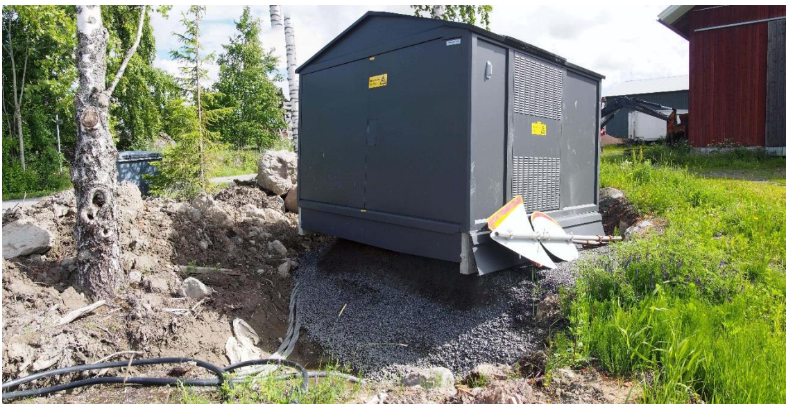
Kuva 23. Jo asennettu muuntamo Uuramontien varressa, Viekkalantien länsipuolella. Tätä kohtaa ei ole määritelty valvottavaksi Pirkanmaan maakuntamuseon lausunnossa 123/2016. Kuvattu lännestä. (Kuva: Sastamala Karkunkylä koekaivaus 2017:17)
