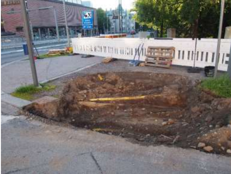
Kuva 7. Tulevalle portaalille kaivettu kuoppa alkutekijöissään Pirkankadun ja Mariankadun risteyksessä. Kuvattu lännestä. (Kuva: Tampere Pyynikin kirkkokuisto 2017: 2)
